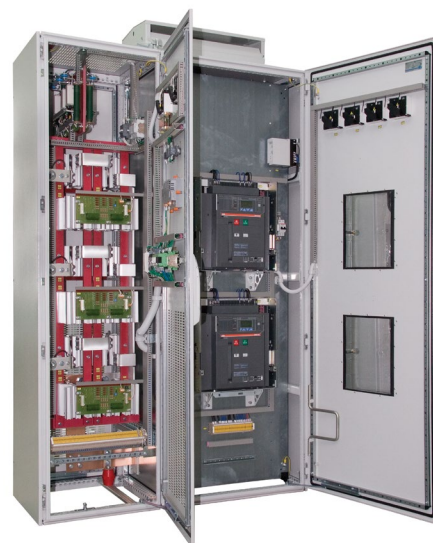
▲ Преобразовательная секция В-ТПЕД и шкаф линейных автоматов ШЛА
